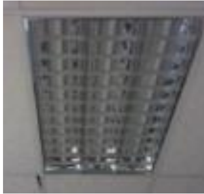
Figura 2. Luminaria actual instalada.
