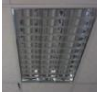
Figure 2. Luminaria actual instalada.
